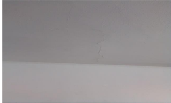
CIELO RASO CON FISURAS 1
