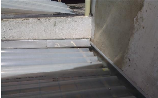
HUMEDADES EN CUBIERTA DE PATIO 1
